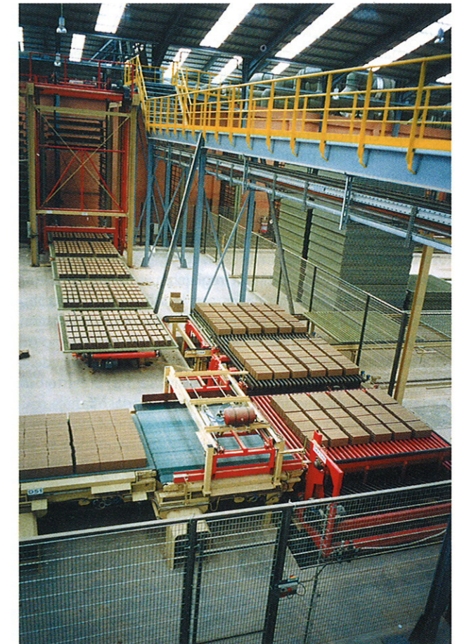
Circuito de bandejas con descarga de los productos secos
