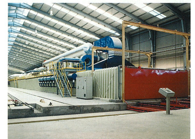
Salida del horno túnel con esclusa de salida
