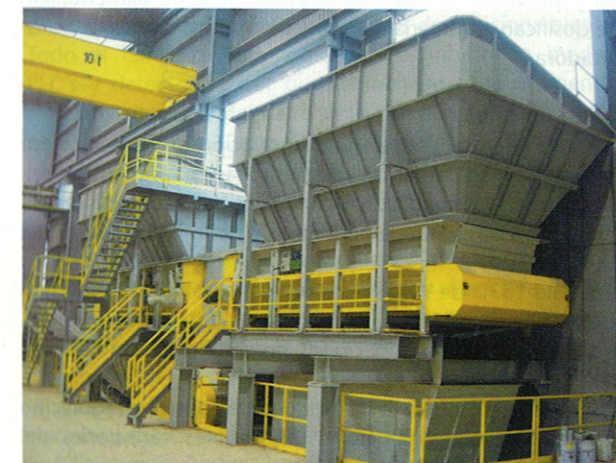
Los dos Alimentadores 029P/6 descargan sobre un desmenuzador 119 DT
