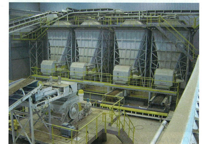
Alimentadores 028P/6 con dosificación gravimétrica
