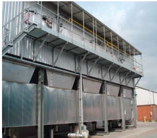
»2 A five-chamber system was installed to ensure good thermal regenerative efficiency »2 Um eine gute thermisch regenerative Effizienz zu erreichen, wurde ein Fünfkammersystem installiert
