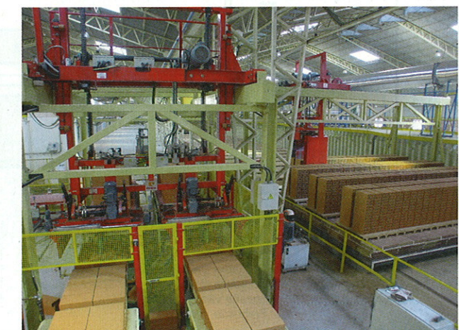
Descarga automática de los vagones cocidos (vista general)
