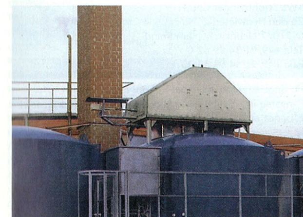
Fig. 3a e 3b: Cappa di aspirazione per il gas caldo con valvola a cassetto sul termoreattore
