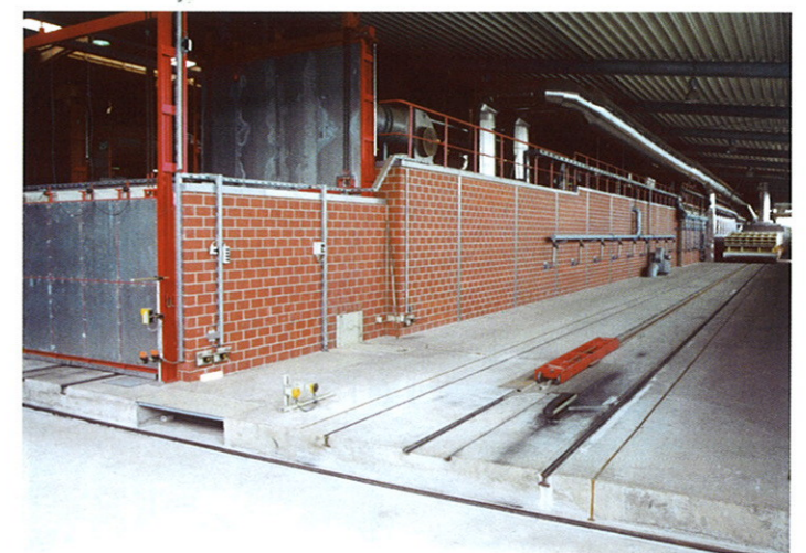
在附属工厂里扩建的 Keller 隧道窑的带闸出口
