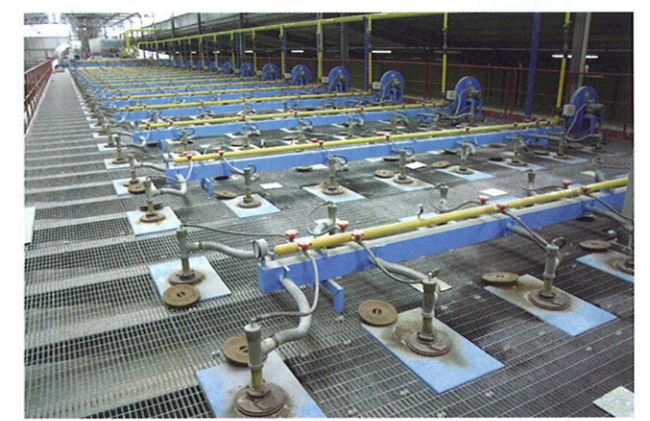
图 5: 带有顶烧烧嘴的窑顶
