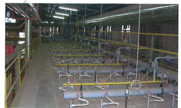
图 9 窑配备新的工艺设备,燃烧装置和 K-matic 控制系统
