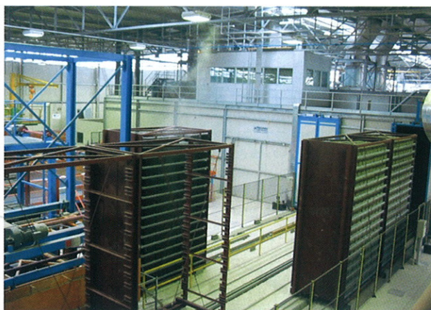
Входная зона сушилки
