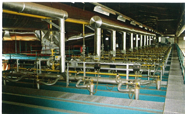
Сводный обогрев туннельной печи
