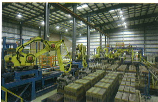
Рис. 8: Очереди 1 и 2 – оборудование для автоматической сдкн
