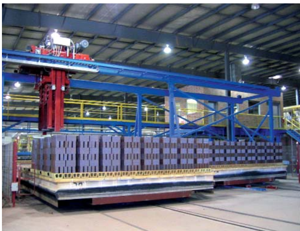
» Обжиговые вагонетки с кирпичами под разгрузочным устройством
