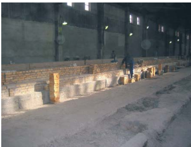
» Туннельная печь облицована футеровочным кирпичом
