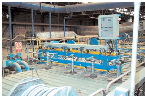
» Горелка Jolly Gas, которая позволяет подавать топливо на 10 точек горения
