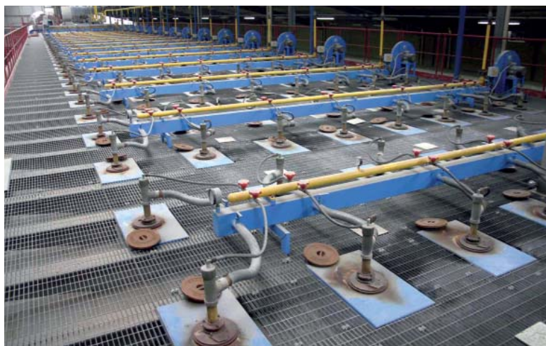
Рис. 5 Потолок печи с верхними горелками
