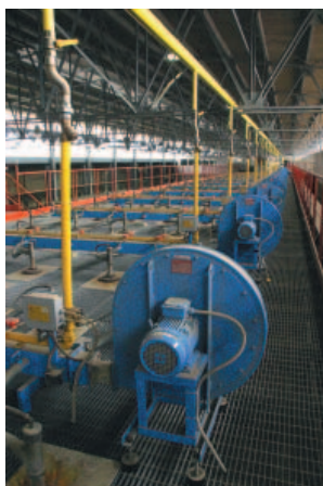
» Горелки на своде печи
