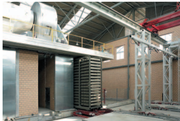
» Laminaris XL: сушильная вагонетка перед входом в сушилку
