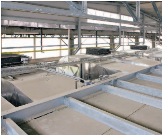
» 5 Нагнетательные вентиляторы и всасывающие газопроводы
