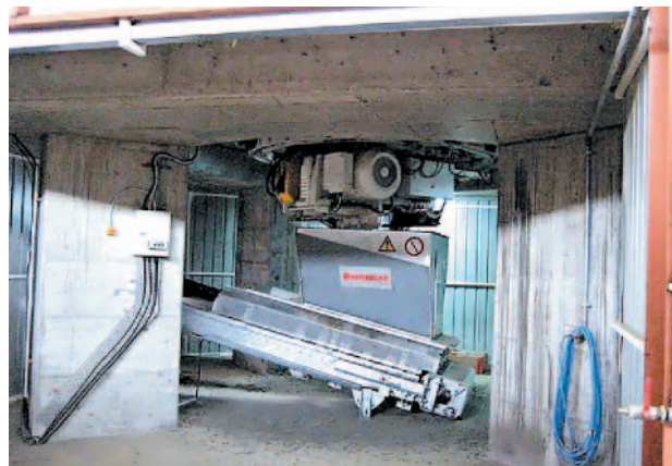
» 11 Фундаментное строение глиняного бункера с механизмом продвижения шнеков
