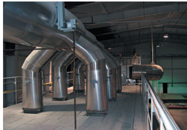
» 8 Вытяжная вентиляция, дутьевой вентилятор
