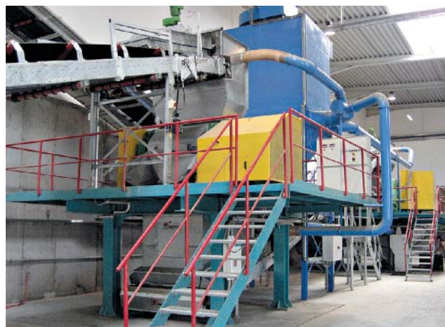
» 7a Противопылевой кожух вальцев тонкого помола типа WF 10120e, с пылеулавливающей установкой на заднем плане
