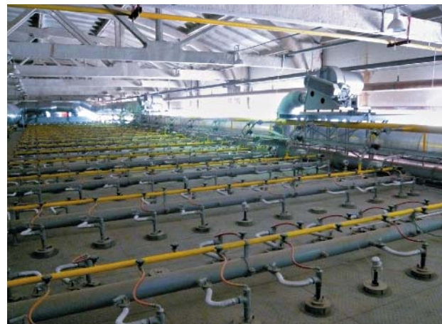
» 7 Свод печи с установкой горелок
