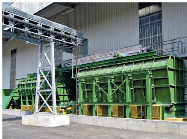
» 5 Блок ящичных питателей на заводе, запитываемых передвижным реверсивным конвейером и конвейерной линией, идущей из карьера
