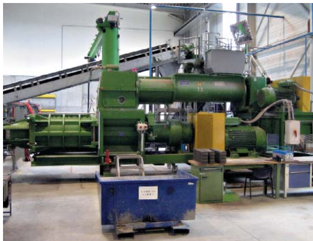
» 13a Комбинированная вакуумная экструзионная установка типа EVMG 75a/70/1025f, установленная на подъемно-опускном механизме
