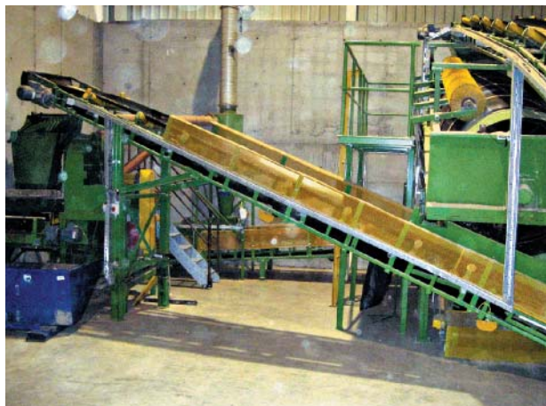
» 9 Установка для подготовки древесных опилок – справа барабанный грохот (с очистной щеткой для удаления липких древесных волокон), слева измельчитель древесных опилок (со встроенным ситом, на переднем плане контейнер для удаленных твердых включений)
