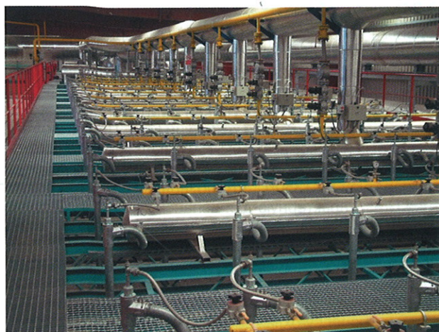
» 7 Туннельная обжиговая печь с пламенной установкой
