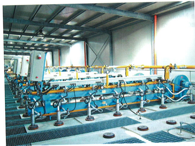
» 2 Горелка Jolly Gas, которая позволяет подавать топливо на 14 точек горения
