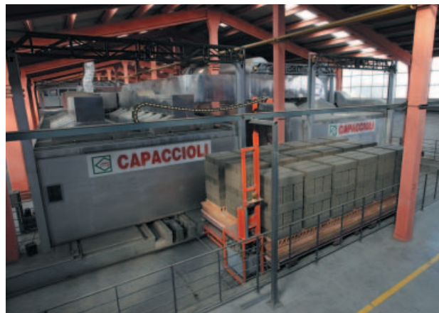
» 3 Вид печи, установленной на заводе «Iasi» (Румыния)
