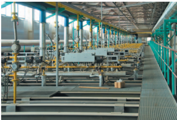
» 4 Горелочная установка на туннельной печи
