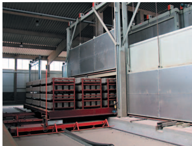
» 7 Шлюз на выходе из сушилки
