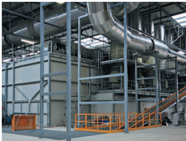
» 9 Влажная сторона сушилки с вытяжными трубами
