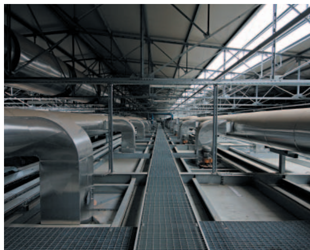
» 8 Воздуховоды на крыше сушилки
