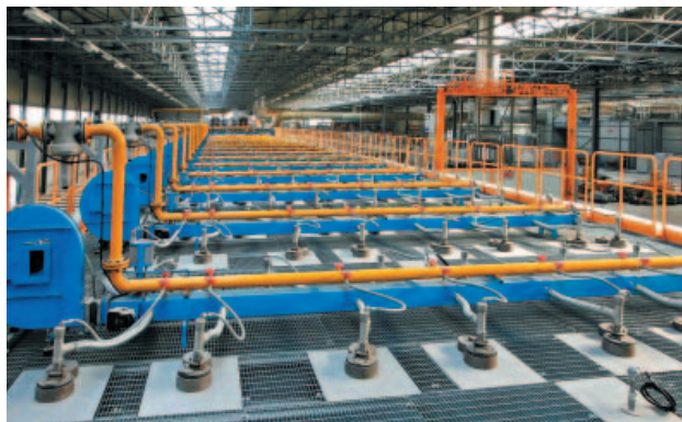
» 14 Вид обжигового оборудования на своде печи
