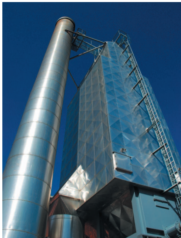
» 15 Система очистки дымовых газов
