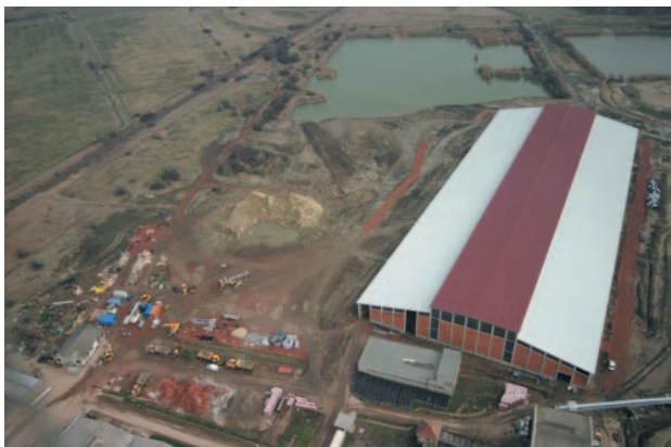
» 2 Вид с высоты птичьего полета на новый завод Csabai II во время строительства
