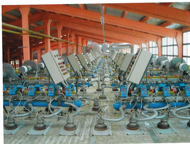
»3 Impianto Ceramica lasi C3 – Soffitto del forno, linea di cottura
