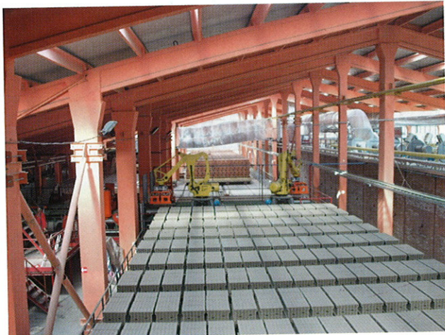
»1 Impianto Ceramica lasi C3 – Impilatrice robotizzata e linee di carri del forno per materiale secco e cotto
