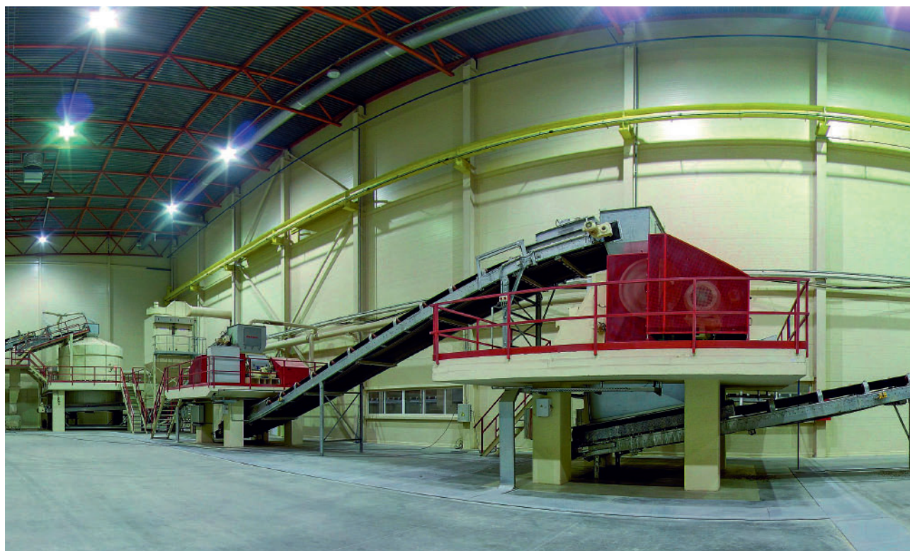
Ligne de préparation constituée d'un broyeur-malaxeur du type HMI 2170c, d'une installation de dépoussiérage, d'un laminoir fin équipé de paliers à réglage axial du type Beta WF 1080e ainsi que d'un laminoir oscillant du type Alpha II WFZH 10120d
